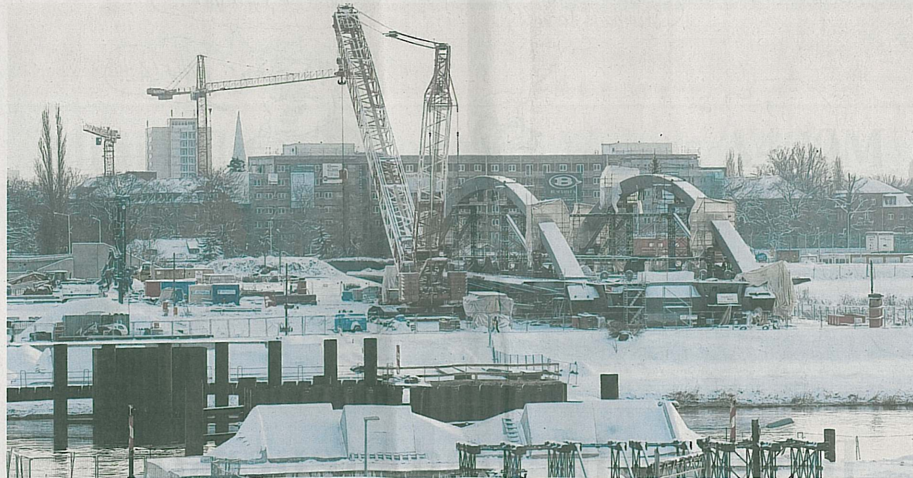
Wegen grimmiger Kälte und Schnee ruht der Bau der Waldschlößchenbrücke: Ob und wann die am Ufer vormontierte Strombrücke auf den Fluss geschoben werden kann, ist fraglich. Die Stadt will Flächen dafür nutzen, die im Planfeststellungsbeschluss nicht enthalten sind. Foto: Sebastian Kahnert
